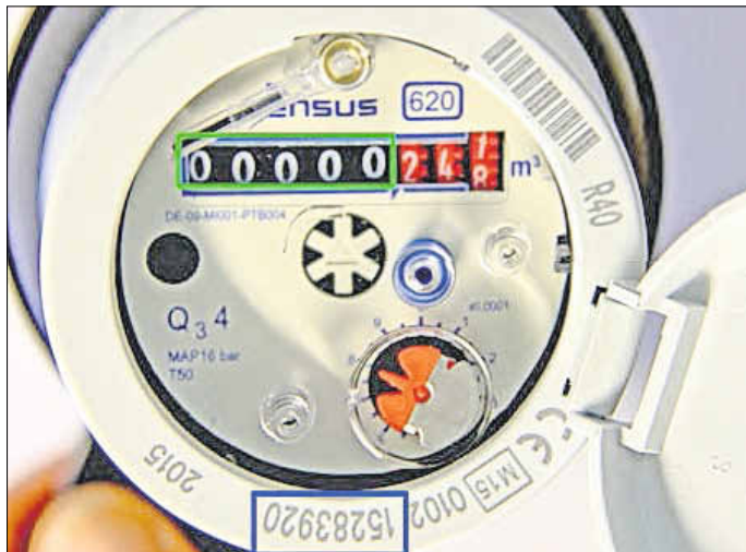
Beispiel Zählernummer 15283920 Zählerstand 0
